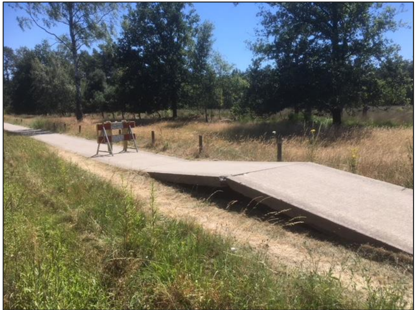
Figuur 14: Hittestress in landelijk gebied in provincie Noord-Brabant: onbegaanbaar fietspad als gevolg van uitzetten van materiaal door hitte
